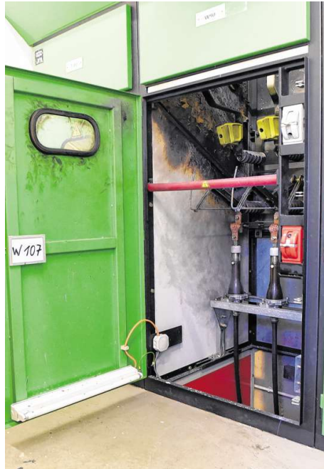
Hier passierte die jüngste Panne: Trafo im Glücksburger Weg, wo gestern Morgen ein Schalter brannte.
